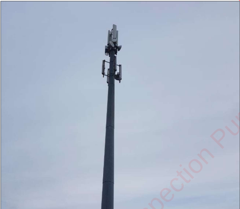
Figure 9.6. Shanettra - Mast A2
